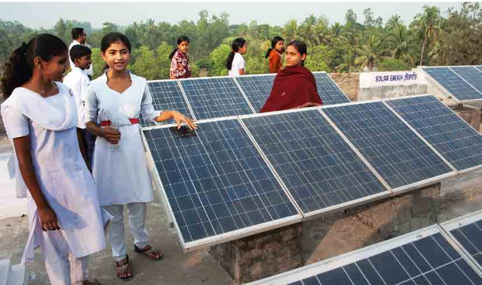
En la escuela Dhablat Laksman, la electricidad es suministrada por paneles solares sin causar emisiones de dióxido de carbono y sin afectar el clima.
